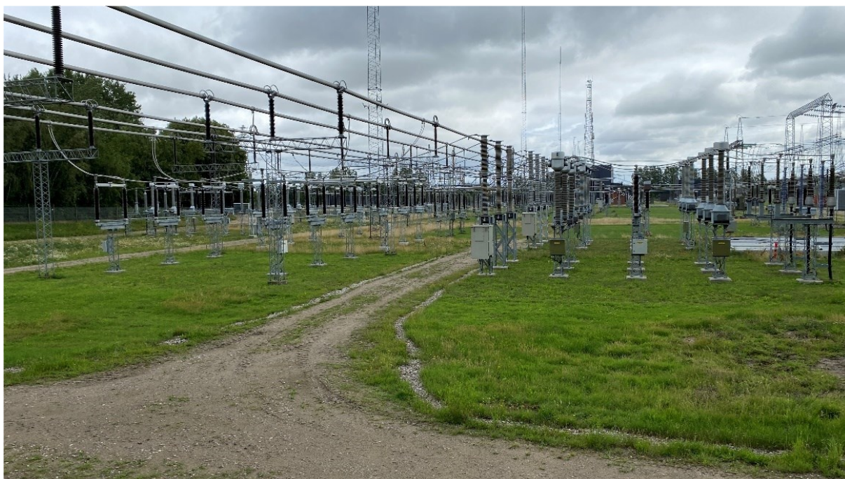
Figur 4 - Visualiseringspunkt nr. 3 fra Figur 1. Viser det eksisterende kabelfelt fra vestlig side, for at give et indtryk af hvordan det opbygget. Betonfundamentet er gravet under jorden og rager en smule op. Metaldelen er kaldet et stativ. På toppen er der en del forskellige komponenter.
