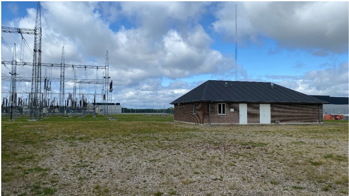
Figur 6 - Visualiseringspunkt nr. 1 fra Figur 5. Viser kabelfelt og samleskinne fra østlig retning. Der bygges noget tilsvarende som det, der er markeret med en grøn firkant. Det udbygges i retningen som pilen viser.
